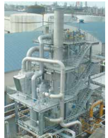
低温熱回収型高濃縮廃液燃焼分解装置 (熱交換型白煙防止)
