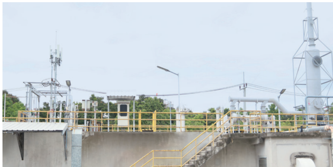
排水処理設備(タイ工場)
