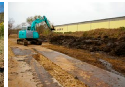
水路掘削で掘りあげられた湿原の表土。これが「あさひ・いのちの森」に搬入された
