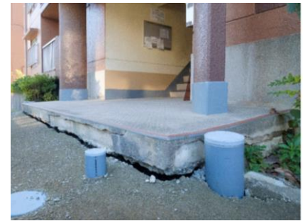
地盤が沈下し地震直後から液状化が発生
