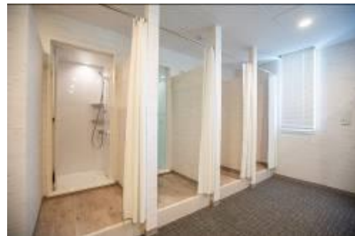
更衣室にはシャワーユニットを配置
