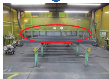
改修後の集塵機(溶接ヒュームの吸い込み口を下方に変更し吸い込み能力は改修前の2.5倍)
