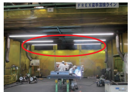
改修前の集塵機(溶接ヒュームの吸い込み口が上方にあり溶接ヒュームの吸い込みが弱い)
