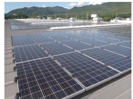
滋賀工場1棟太陽光発電パネル
