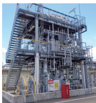
プラノバ大分工場 蒸留設備
