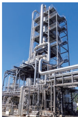
岡富工場 蒸留設備
