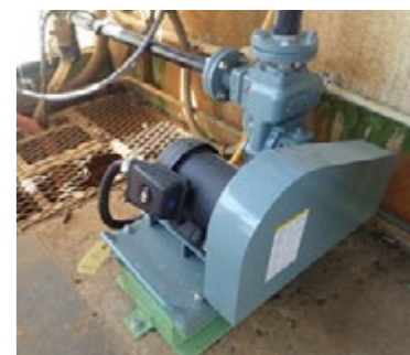
排水処理場 凝集汚泥返送ポンプ
