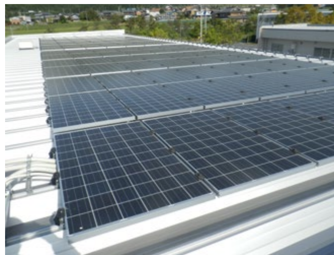
K棟太陽光発電パネル
