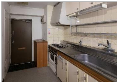
給排水管の劣化は補修することが困難な状況でした。
