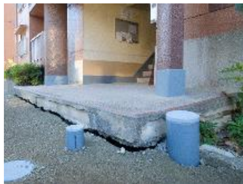
地盤が沈下し地震直後から液状化が発生
