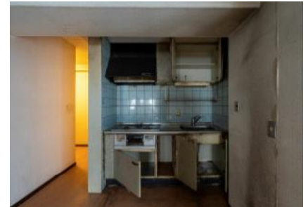
老朽化したキッチン設備
