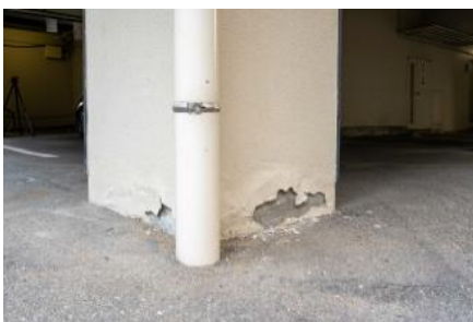
劣化した外装
